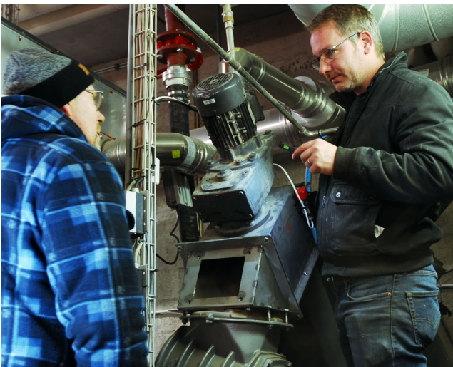
Fireforce-Anlage mit 500 kW Leistung
