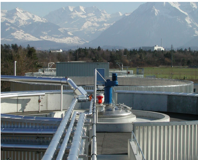
Die Abwasserreinigungsanlage Thunersee
