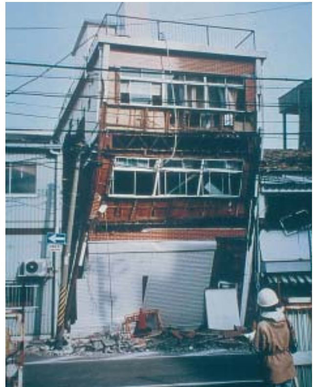
19/1 Dieser Stahlrahmen erlitt grosse verbleibende Verformungen. Vermutlich waren keine weiteren Aussteifungen vorhanden, und die Ausbildung der Knoten für zyklische Beanspruchung war mangelhaft (Kobe Japan 1995).
