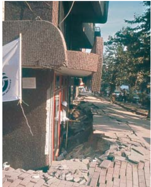
30/1 Dieses Gebäude ist infolge Bodenverflüssigung um etwa 1 m gleichmässig abgesunken. Das verdrängte Bodenmaterial hat die Strasse aufgewölbt (Izmit Türkei 1999).
