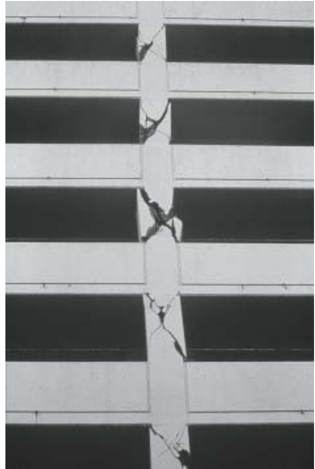
16/1 Die Kreuzrisse und Schubbrüche in den kurzen Stützen eines Parkhauses haben beinahe einen Einsturz bewirkt (Northridge Kalifornien 1994).
