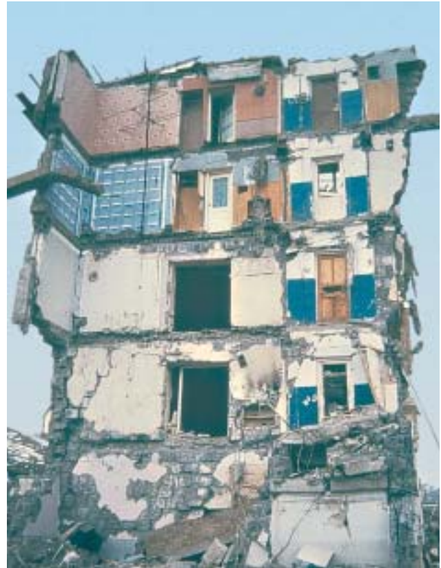
22/2 22/3 Auch bei diesen Wohnhäusern bestanden die Decken nur aus vorgefertigten Platten, die unter sich und mit den Wänden ungenügend verbunden waren (Armenien 1988).
