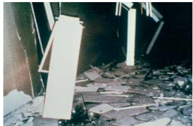
34/3 34/4 Auch solche schlecht befestigte oder nur in die Decke hineingesteckte Beleuchtungskörper können abstürzen und Personen gefährden (San Fernando Kalifornien 1971).
