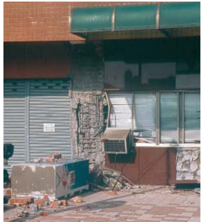
4/8 ... dank massiven Stützen mit konstruktiv gut durchgebildeter Stabilisierungs- und Umschnürungsbewehrung (Taiwan 1999).
