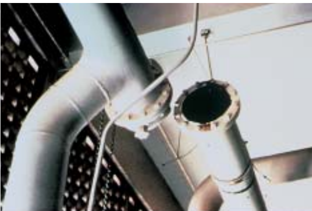
35/1 Rohrleitungen – vor allem solche mit grösseren Durchmessern – weisen eine hohe Verletzbarkeit auf, sofern sie nicht wirksam befestigt sind (San Fernando Kalifornien 1971).
