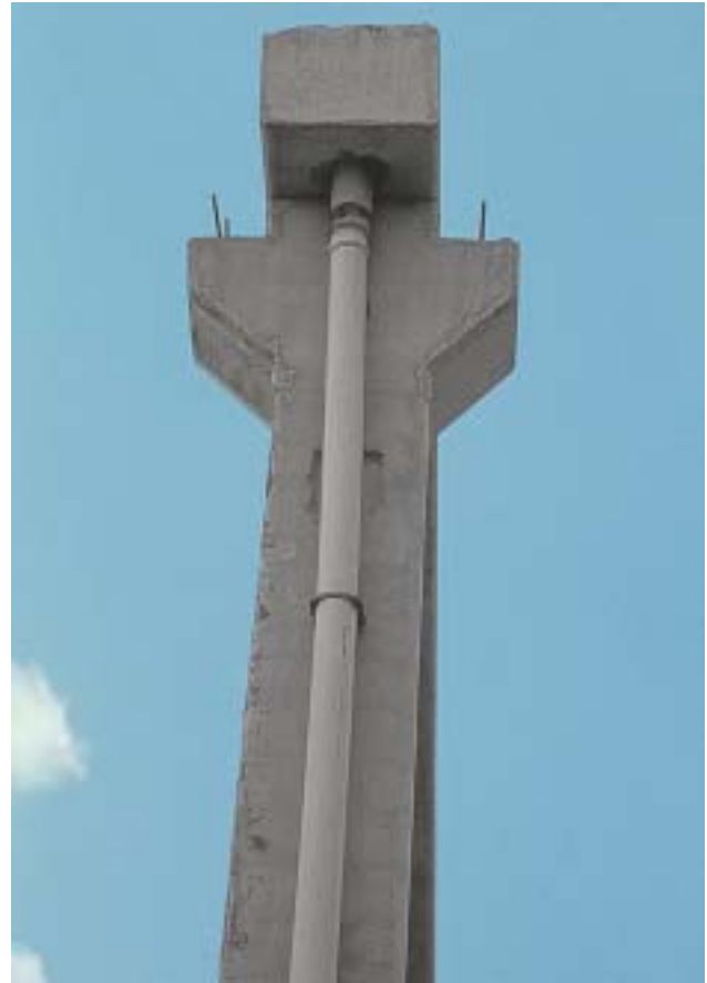
27/1 Auf den Stützenkonsolen einer vorfabrizierten Fabrikhalle waren zwar Schubdorne jedoch keine genügenden Kippsicherungen vorhanden. Der Auflagerbereich hat versagt, die Hauptträger sind seitlich – d.h. in Hallenlängsrichtung – ausgekippt ...
