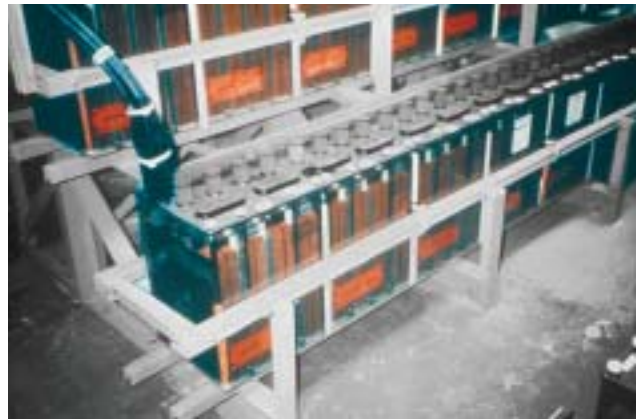
35/7 Gut gesicherte Batteriangruppen und Notstromaggregate können auch nach einem starken Erdbeben die Energieversorgung gewährleisten (Kalifornien 1980).
