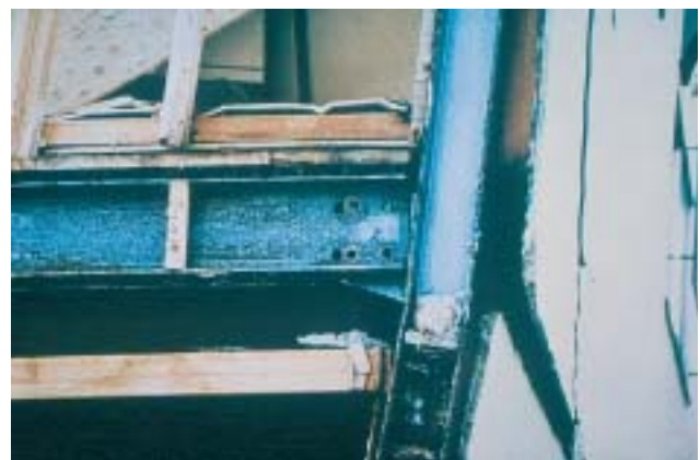
19/2 Hier versagten die Schrauben in der Verbindung des Trägers zur Stütze (Kobe Japan 1995).
