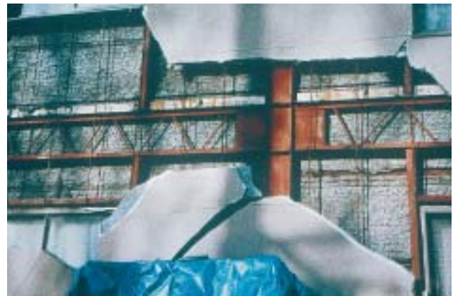
32/2 Auch diese Leichtbetonplatten als Verkleidung eines wenig beschädigten Stahlbaus wurden zerstört (Kobe Japan 1995).
