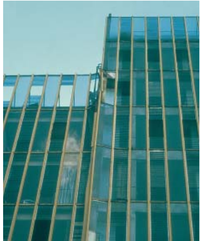
20/1 Bei dieser Fuge zwischen zwei ähnlichen Gebäuden mit Geschossdecken auf gleicher Höhe bewirkte der Zusammenprall Schäden in den Fassaden sowie Abplatzungen usw. am Tragwerk (Mexico 1985).
