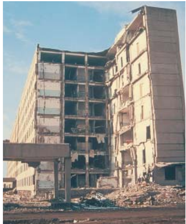
22/1 Bei diesem Gebäude ist ein Eckbereich eingestürzt. Die Decken bestanden nur aus vorfabrizierten Elementen ohne bewehrten Überbeton und ohne bewehrte Verbindungen zu den vertikalen Tragelementen (Armenien 1988).
