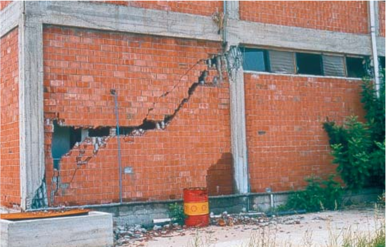
11/3 Auch hier war das Mauerwerk stärker; es hat die relativ massiven Stützen abgeschert (Adana-Ceyhan Türkei 1998).
