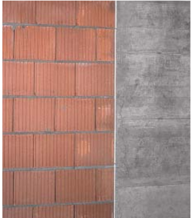
15/3 Diese Fuge zwischen der Mauerwerkswand und einer Stahlbetontragwand wurde durch Hartschaumplatten gefüllt. Hartschaumstoff ist für Erdbebenverschiebungen jedoch zu steif; ein besser geeignetes Material ist z.B. Gummischrot (Schweiz 1994).
