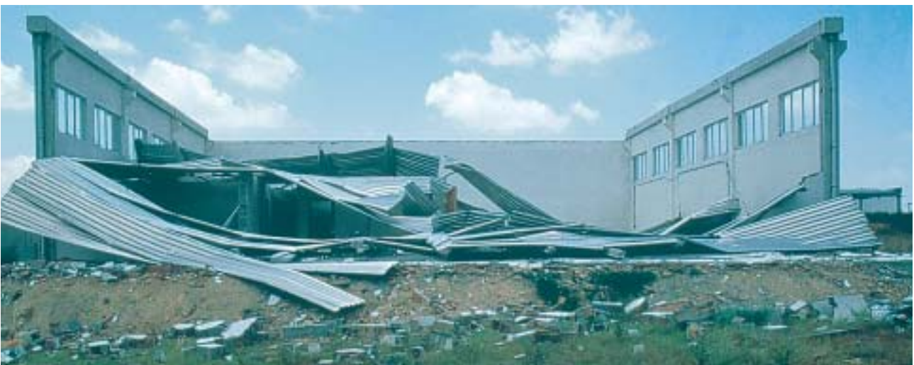
27/2 ... und die gesamte Dachkonstruktion ist abgestürzt (Adana-Ceyhan Türkei 1998).
