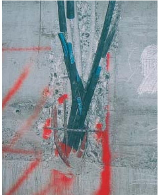
26/5 Auch solche ungeplant verlegte Leitungsstränge können das Erdbebenverhalten einer Stahlbetontragwand beeinträchtigen (Schweiz 2001).
