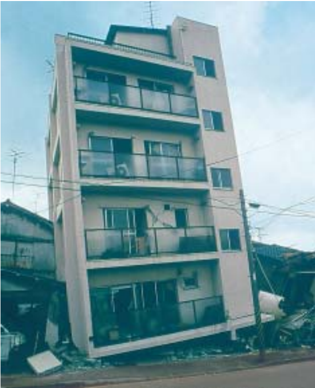
4/5 Dieses oben gut ausgesteifte Gebäude ist um das Erdgeschoss abgesackt ...
