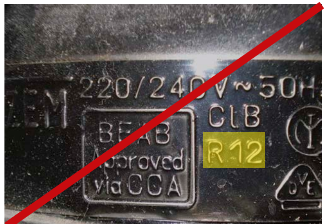
Kältekompressor mit verbotenem Kältemittel R12
