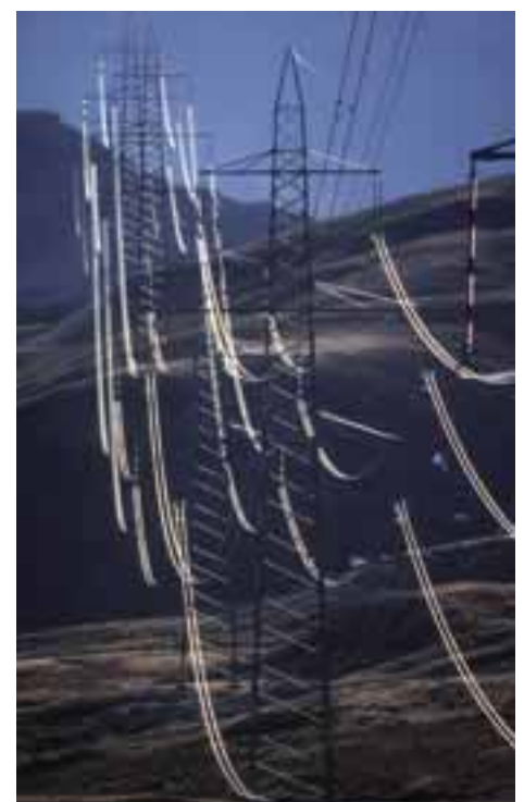
220-kV-Freileitung bei Laax GR.
