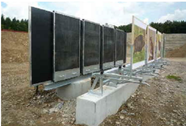
Fig. 26: Caissons de pare-balles pour installations de tir de chasse 100m à 150m, [14].
