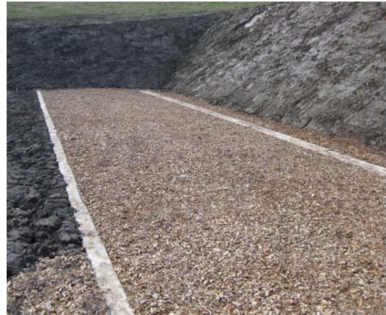
Fig. 36: Installation de tir polyvalente MZA 31, Reppischtal: surface étanche au-dessus du réservoir de gravier, à droite nouveau matériel du pare-balles au-dessus du système d'étanchéité. Photo magma SA, 2.3.2011, aus [18].
