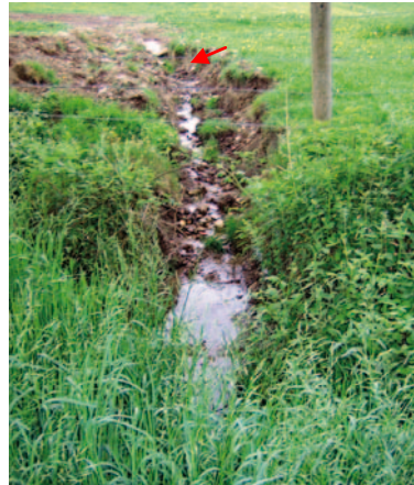
Abb. 4 > Entwässerungsrohr mit einer Senke am Ufer
