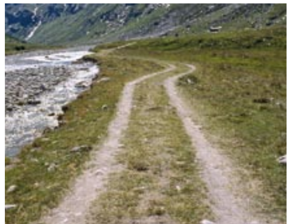
Der Zugangsweg ist durch Erosion gefährdet und sollte gegebenenfalls ausserhalb des Dynamikbereichs des Fließgewässers neu erstellt werden; Lampertschalp, Nr. 1323 GR (Foto: Auenberatungsstelle)
