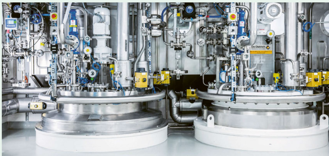
Reaktorbehälter in der Produktionsanlage «SLF 50» von Roche in Basel. Hier werden hochaktive Stoffe hergestellt.
