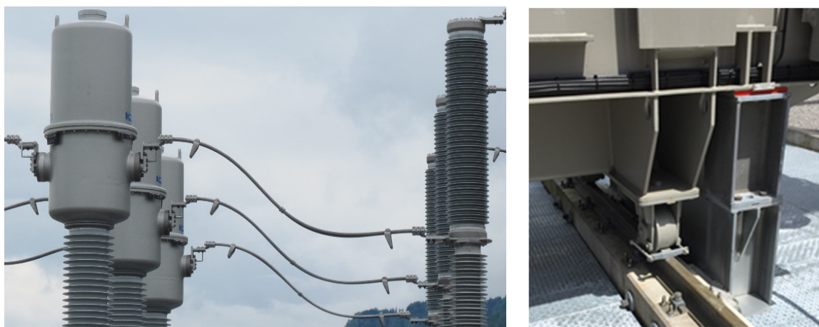
Abbildung 7: Unterwerk Rüthi - Links: Erdbebengerechte Leitverbindungen mit Lose zwischen Hochspannungsapparaten (swissgrid); Rechts: Verankerung eines Transformators (SBB).
