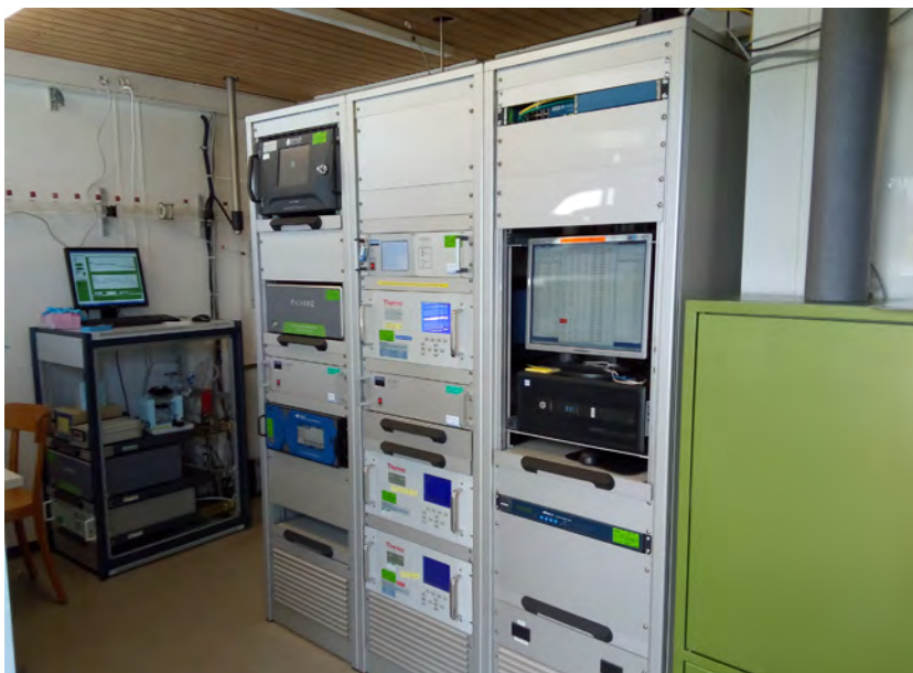
Abb. 2-48: Innenansicht einer NABEL-Station
