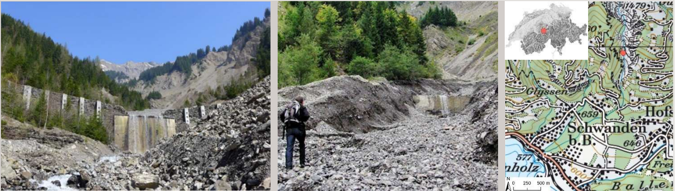
Alternde Schutzbauten (links [60], Mitte [Jungfrauzeitung 2019])
