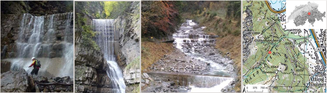
Alternde Schutzbauten v.l.n.r. Sperre 5 und Sperre "Loch" im EZG, Schwellen am Kegelhals [69]
