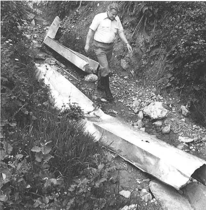
Abb. 3: Durch Unwetter beschädigte offene Kännel (Pfiffegg, Wägital). Foto: J. Zeller
