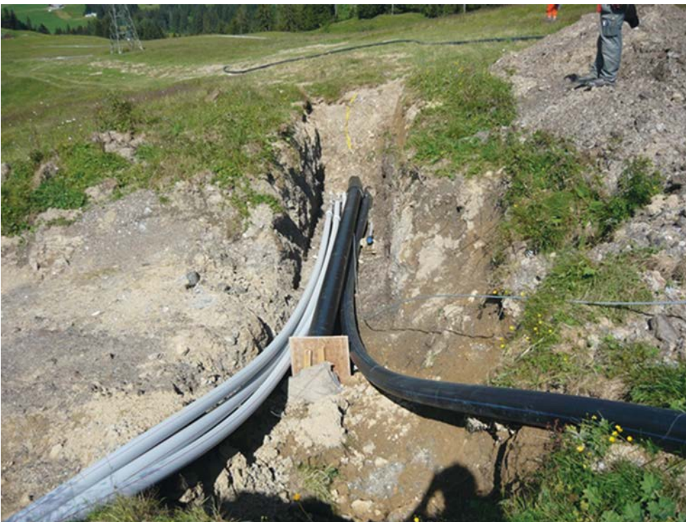
Abb. 11 > Der Leitungsbau zur Speisung der Schnee erzeugende Anlagen kann die natürlichen Lebensräume und den Boden beeinträchtigen.
