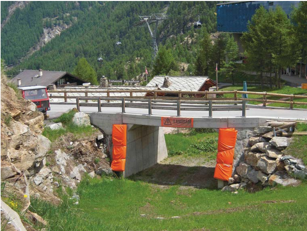
Abb. 6 > Zahlreiche Kunstbauten werden zur Querung von Verkehrswegen errichtet. Die Verwendung natürlicher Baumaterialien (Stein) und das Entfernen der Schutzvorrichtungen im Sommer reduzieren Beeinträchtigungen des Landschaftsbildes.
