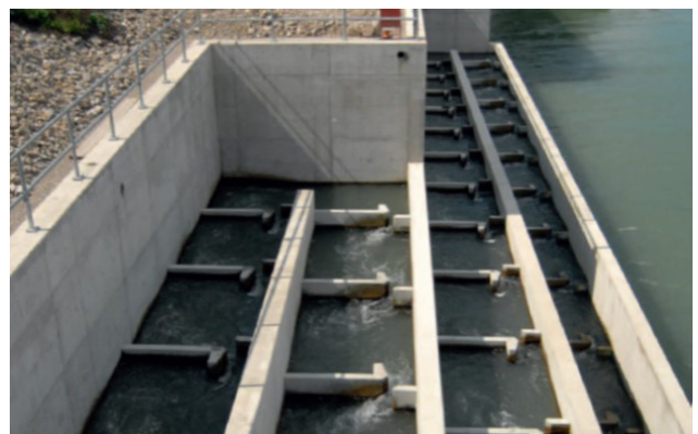
Vertical-Slot-Fischpass am linken Rheinufer (Bild: Energiedienst)
