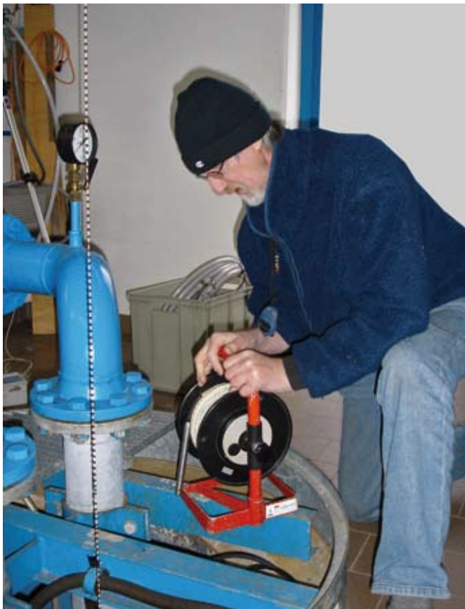
Messung des Grundwasserstandes in einem Trinkwasser-Pumpwerk im Tessin.
