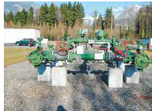
Molchschleuse bei Aigle (VD) zur Inspektion der Rohrleitungen
