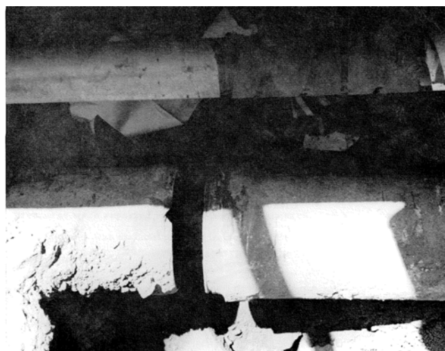
Bild A.3: San Fernando Erdbeben: Auseinandergezogene Leitungsstücke einer 10 inch Gasleitung im Glenoaks Boulevard (aus (4)).
