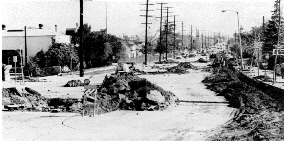
Bild A.1: San Fernando Erdbeben: Gaslecks in einer Hauptleitung im Glenoaks Boulevard, die 14 Aufgrabungen notwendig machten (aus (4)).
