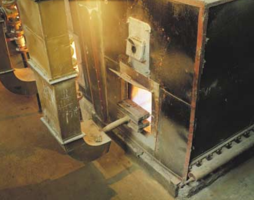
Zu ersetzender Gasboiler in Pascani (Rumänien)
