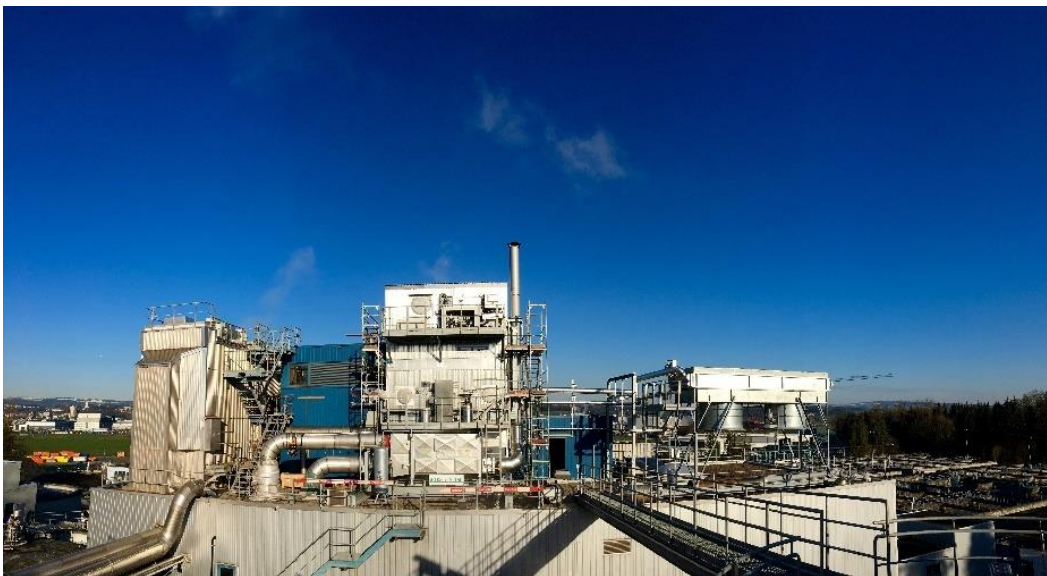
Abbildung 1: RTO Anlage auf dem Dach der Klärschlammverbrennung
