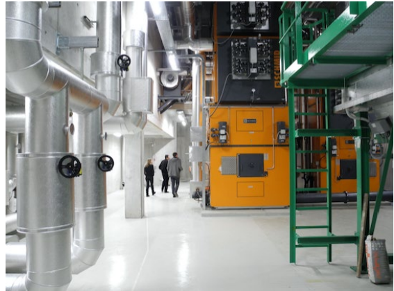
Abbildung 2: Holzsnitzelheizkessel im Heizwerk Losone.
