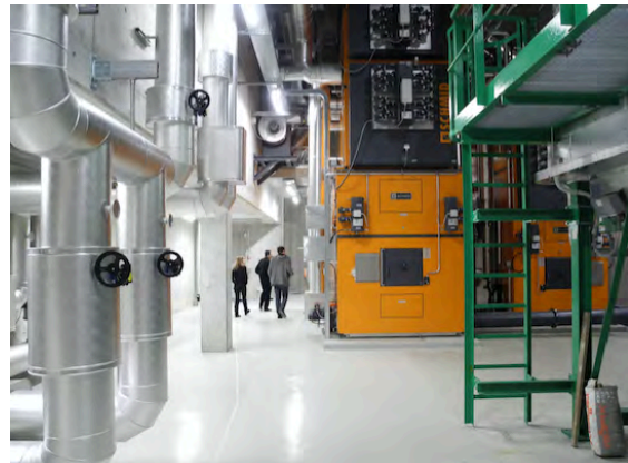
Bild 2: Holzschnitzelkessel im Heizwerk Losone.
