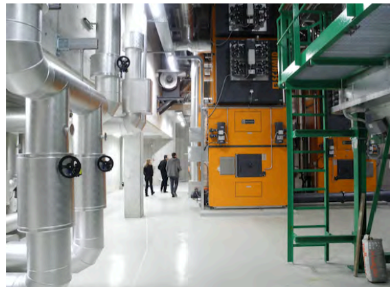
Bild 2: Holzschnitzelkessel im Heizwerk Losone.
