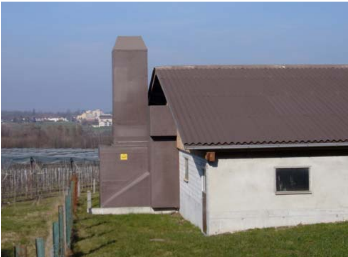
Konventioneller Biowäscher zur Abluftreinigung bei einem Schweinestall
