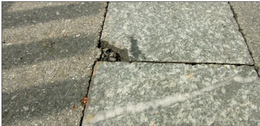
Abb. 13: Dorfstrasse, Detail Granitband (mit Beschädigung)
