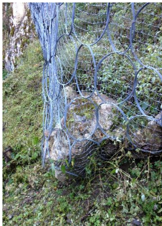
Abb. 1: Durch ein Schutznetz zurückgehaltene Steine und Blöcke (Quelle: Bernard Loup)
