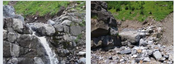
Abb. 18: Schutzbauten an der Guppenrunse, vor (links) und nach (rechts) dem Murgangereignis von 2011 [41]
