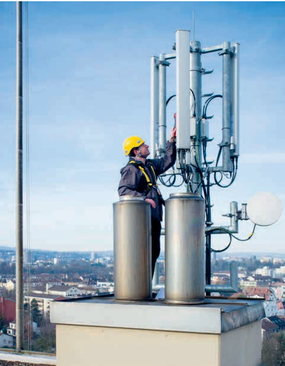
Andreas Weber prüft, ob die neu errichtete Mobilfunkanlage auf dem Dach eines Hochhauses in Birsfelden (BL) den gesetzlichen Auflagen entspricht.
