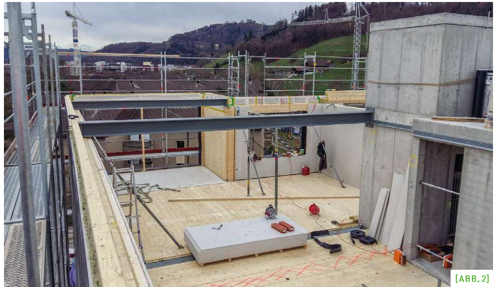
[ABB. 2] Rund um den Liftschacht werden die Elemente, die in Ramsei vorproduziert wurden, platziert. (Foto: zVg)
