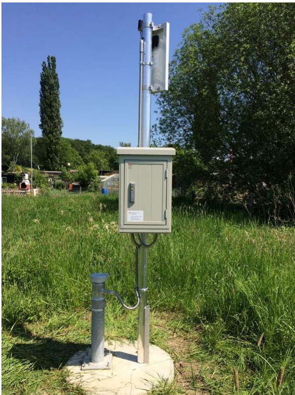
Piezometermessstelle NAQUA-QUANT zur Beobachtung des Grundwasserstandes.
