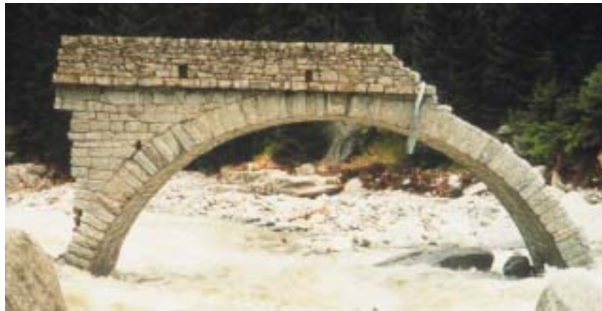
Uri 1987: Die Gewalt des Hochwassers zerstörte Strassen- und Bahnverbindungen.
