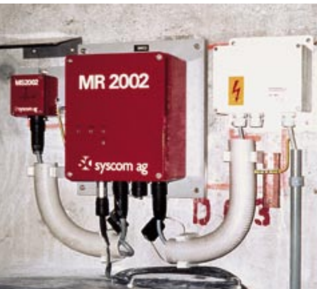
Zum Schutz vor Felsstürzen wird auch das Einzugsgebiet der Speicherbecken regelmässig überwacht (oben). In der Staumauer Mauvoisin (unten) registrieren Messgeräte jede Erschütterung.
