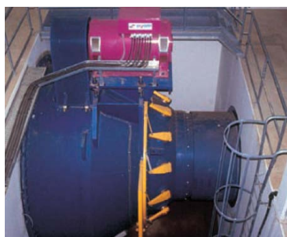
Kaplan-Rohrturbine mit Riementrieb zum aufgesetzten Generator
