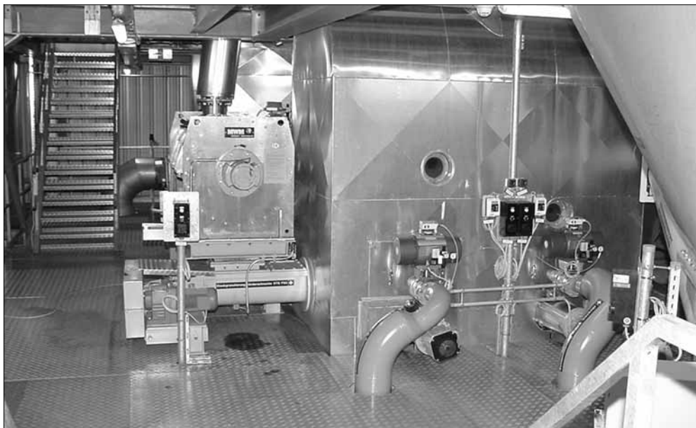
Figure 5: Installation de séchage par lit fluidisé
