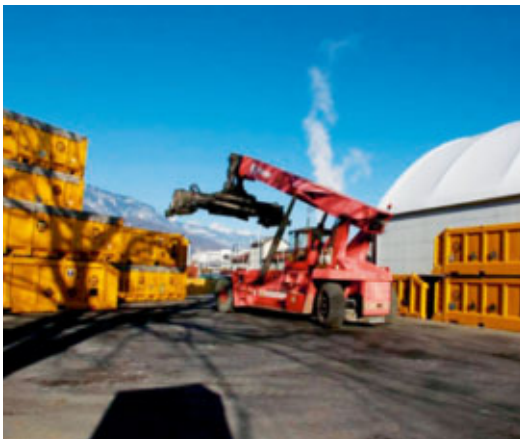
Matériau d'excavation prêt à être transporté, décharge du Pont Rouge à Monthey (VS)
