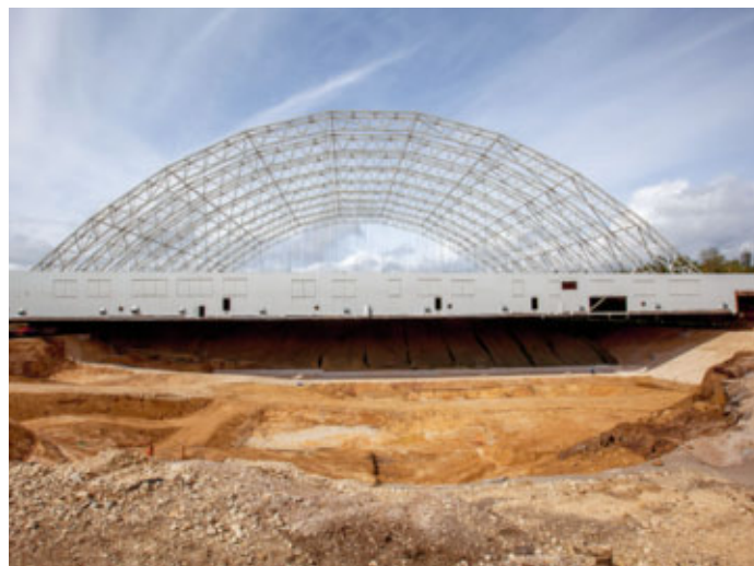
A la décharge de Bonfol (JU), les déchets sont excavés à l'intérieur d'une halle.
