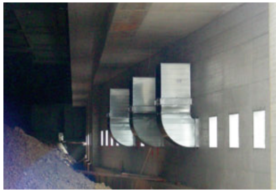
Un système de filtration de l'air vicié empêche la pollution des environs.
