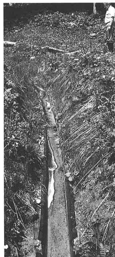
Fig. 2 : Les fossés dans les zones de glissements ne permettent généralement de dériver que les eaux de surface (Pfiffegg, Wägital).
