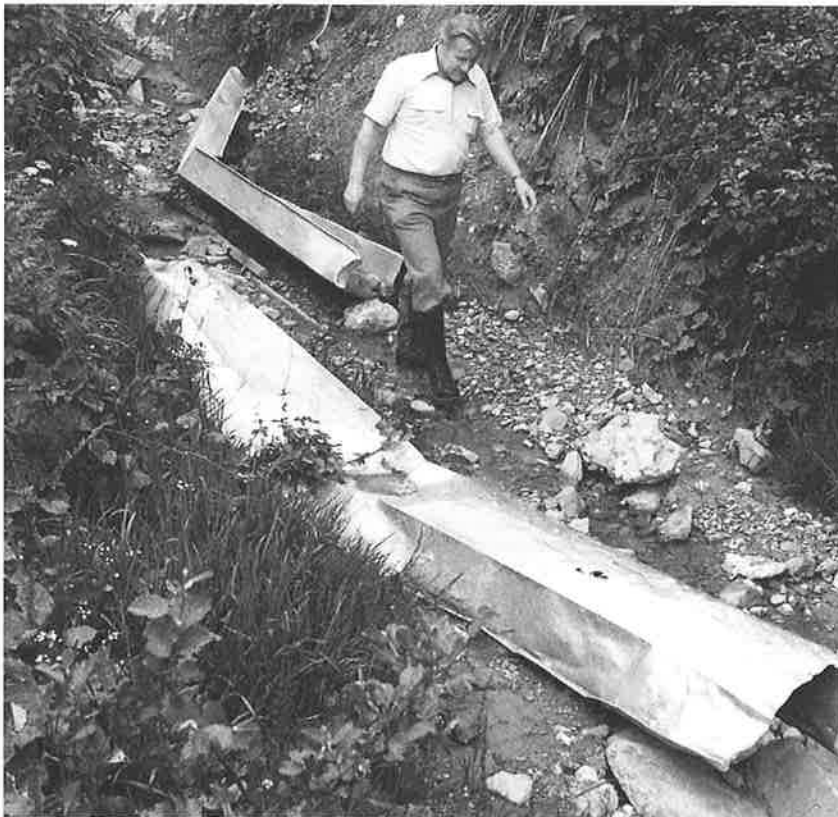
Fig. 3 : Canal ouvert endommagé par les intempéries (Pfiffegg, Wägitäl).
