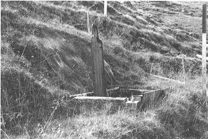
Fig. 2: Caisson de ciblerie fraîchement mis en place. La butte de tir située derrière est protégée par des toiles de jute, tandis que celle située devant est couverte de mottes de gazon. Photo: E. Suter
