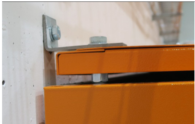
Sécurisation d'une armoire de commande (image OFEV)
