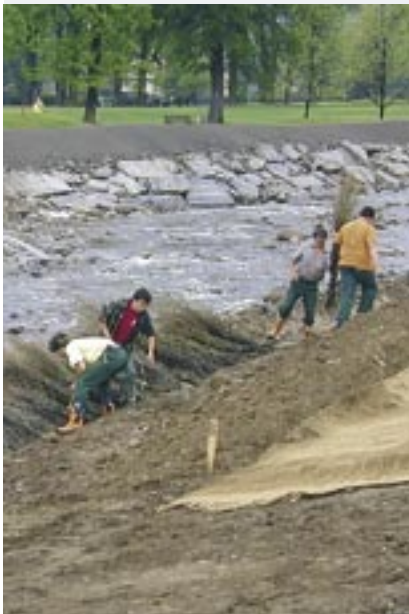
Aménagement de cours d'eau sur la Magliasina (TI) à l'aide du génie biologique.
