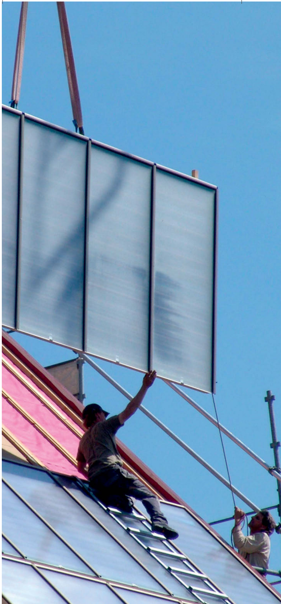
Jenni Energietechnik AG, Berthoud
