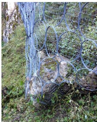
Fig. 1: Blocs et pierres retenus par un filet de protection (Source: Bernard Loup)
