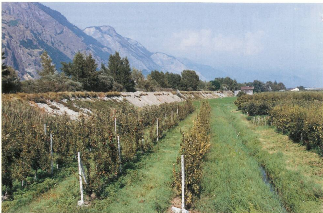
Photo 7: Les digues du Rhône ont été gravement menacées par les niveaux élevés, mais aussi par l'érosion du pied aval des talus à la suite des percolations.
