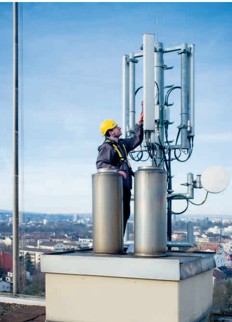
Andreas Weber vérifie que la nouvelle installation de téléphonie mobile située sur le toit d'un immeuble à Birsfelden (BL) obéit bien aux normes.
