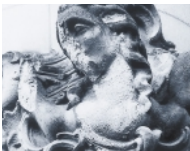
Gli acidi gassosi (prodotti da \text{NO}_2 e \text{SO}_2 ), trasportati con particelle di polvere o con la pioggia, possono causare danni agli edifici e addirittura distruggere monumenti.
