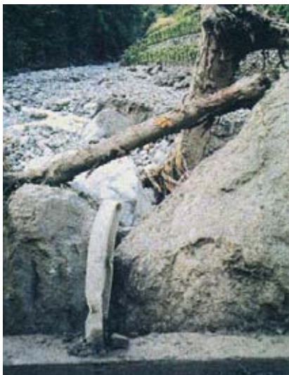
Photo 2: Amont du pont de la route du Gr. St. Bernard: amoncellement de pierres, de blocs ( \varnothing > 2 m) et de troncs derrière le tablier (photo du 15 octobre 2000).
