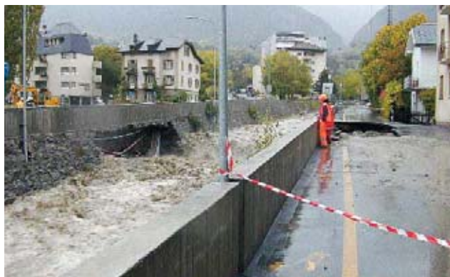
Foto 7: Einbruch der Ufermauer bei einer Sperre am 15. Okt. 2000.
