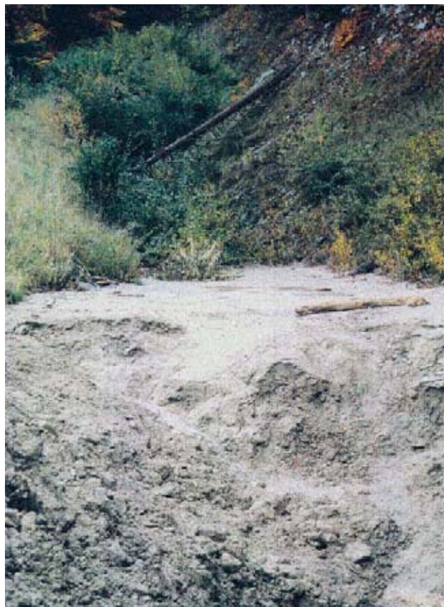
Photo 1: Digue située à 900 m s. m: remplissage deltaïque de sables et de limons dans la digue de Ravine Neuve (photo du 27 oct. 2000).
