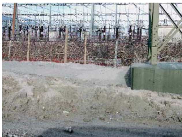
Photo 12: Limons à la station de couplage (EOS)
