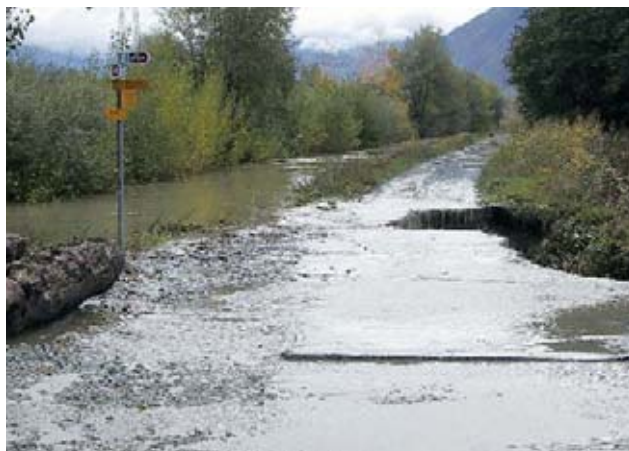
13h00: Le talus extérieur s'effondre
