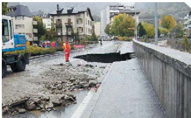
Foto 8: Einbrüche der Ufermauer bei einer Sperre am 15. Okt. 2000.
