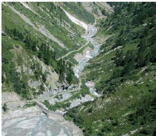
Photo 2: Érosion du Zwischbergenbach directement en aval de la retenue de Fah et engrèvement de la retenue de Fah.
