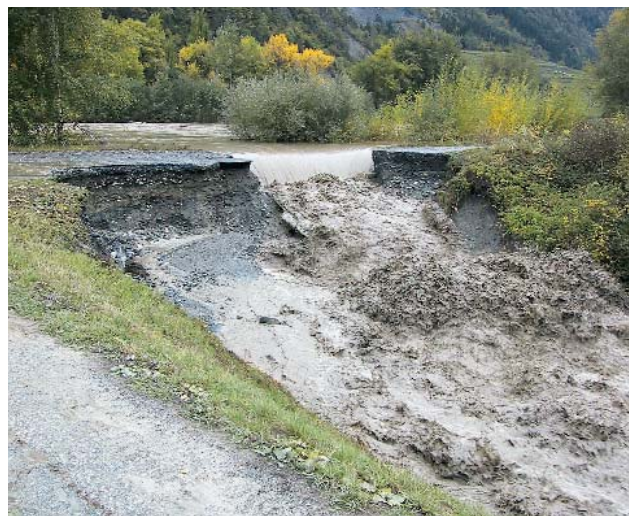
13h15: Erosion de la couronne de digue
