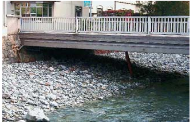
Photo 4: Photo sous le pont reliant le parking à l'usine Alcan après la crue (source: Alcan).
