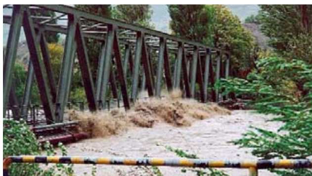
Photo 2: Photo au pont Alcan lors de la crue du 15.10.2000 (source: Alcan).
