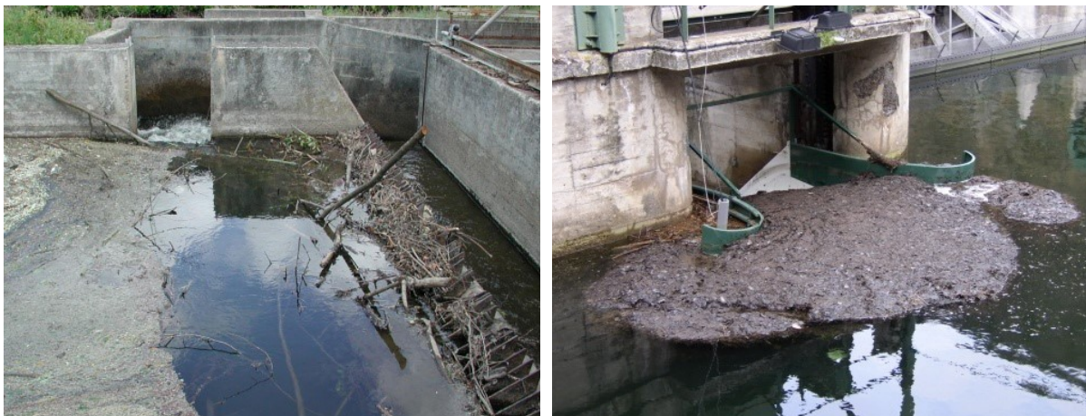
Abb. 8: Geschwemmselansammlungen im Bereich des Rechens sowie beim Bypasseinstieg erschweren oder verunmöglichen einen Fischabstieg (Hilaire & al. 2014)
