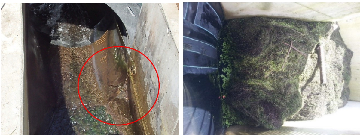
Abb. 7: Abstehende Metallteile u. ä. können in schnell fliessenden Bypässen zu Verletzungen absteigender Fische führen, ebenso wie Geschwemmselansammlungen innerhalb oder unterhalb von Bypässen (Aqua-rius/Økland et al. 2016)
