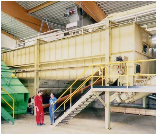
Abb. 17 Mittlergrosser Bandrockner bei ecoTwin Anlage, einer Kombination von ecoDry und KUVU Bandrockner
