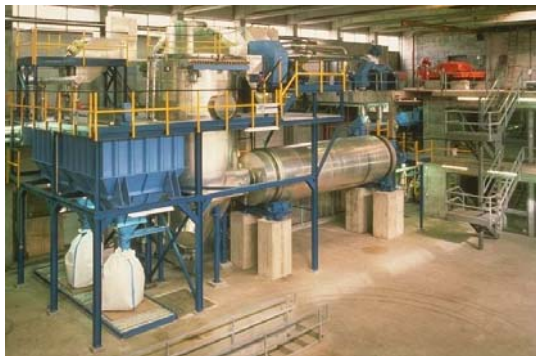
Abb. 5 Klärschlamm-trocknungsanlage Biel Erste ecoDry Anlage in Betrieb seit 1989
