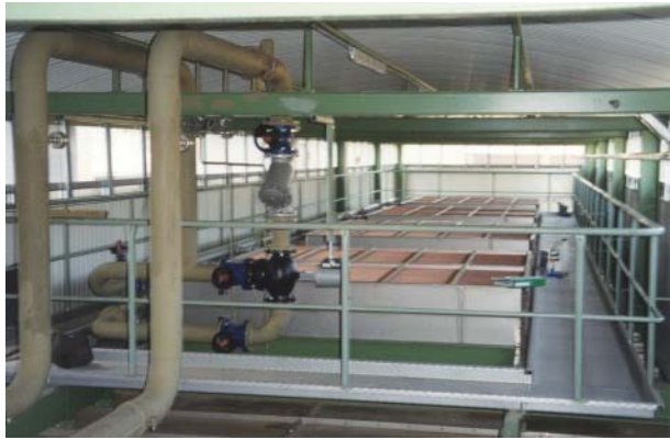
Abb. 15 Anordnung der Lamellenwärmetauscher zur Warmlufterzeugung
