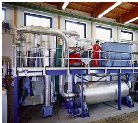
Abb. 9 ecoDry -Versuchsanlage beim WKI Braunschweig
