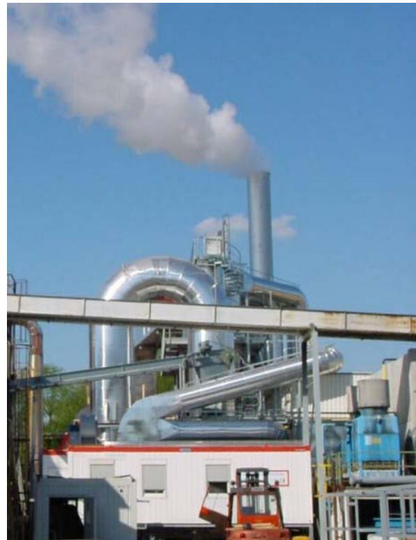
Abb. 12 Neuste ecoDry Anlage für Holzspäne bei der Firma Heggenstaller in Unterbernbach
