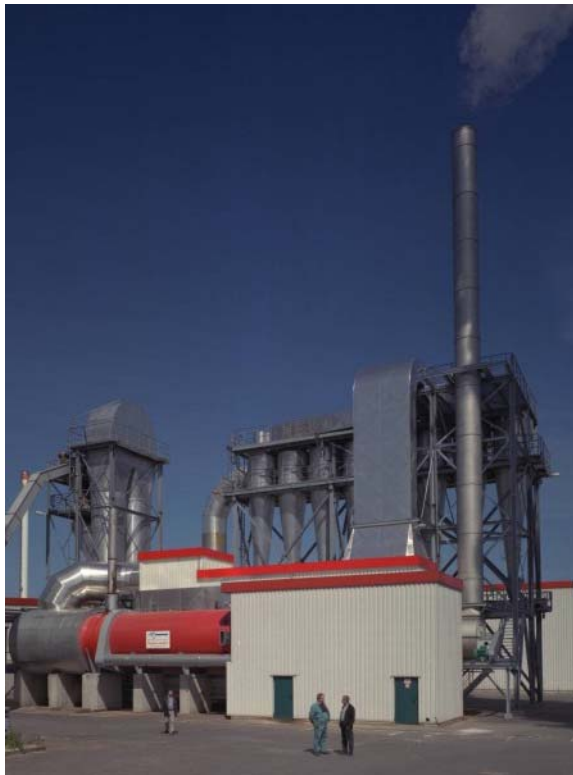
Abb. 11 Auf ecoDry umgebaute Anlage bei der Firma Heggenstaller in Uelzen
