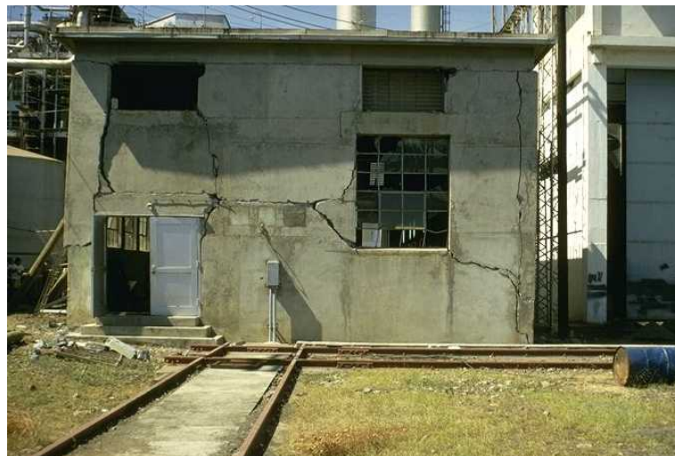
Bild 6.12: Nicaragua, 1972 ( M = 6.2 ): Gebäude mit Sekundärsystemen kurz vor dem Einsturz; ein ähnliches Schadenbild ist auch in der Schweiz möglich. Foto: K.V. Steinbrugge.
