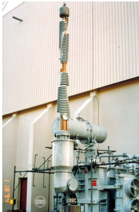
Bild 3.2 Northridge, 1994: geborstene Transformator-Durchführung (500 kV).
