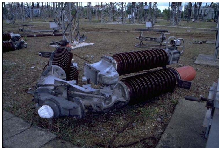
Bild 3.3 Kocaeli, 1999: zerstörte, kopflastige Leistungsschalter in einem UW in Adapazari (Spannungsebene unbekannt) (Foto: A.S. Whittaker).
