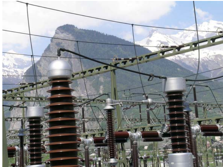
Bild 6.8: Straffe Leiterverbindungen zwischen Kabelendverschluss und Spannungswandler in Chamoson (220 kV).
