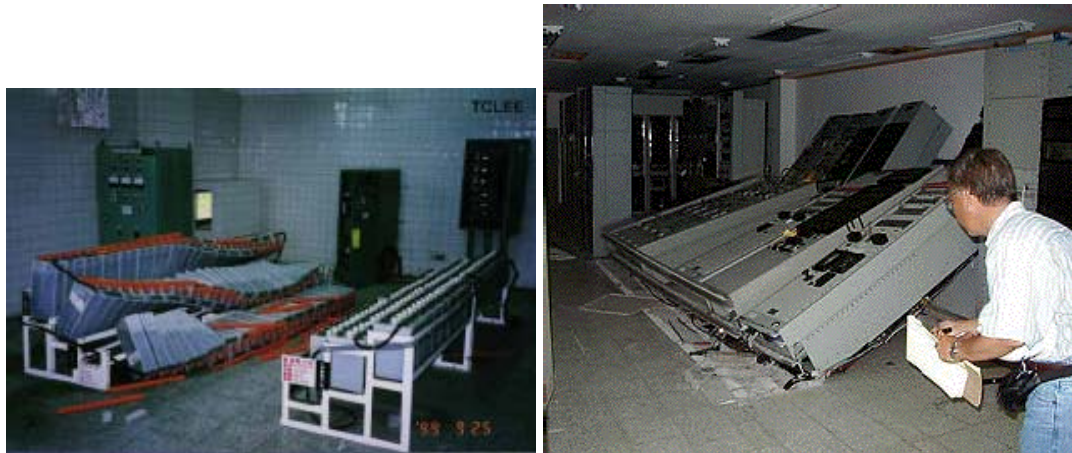
Bild 3.4: Umgekippte Batterien und Steuerschränke im Unterwerk Chungliao nach dem Chi-Chi-Beben ( M_w = 7.6 ), Taiwan, 1999 (Fotos: ASCE-TCLEE bzw. EQE International Inc., aus [2]).
