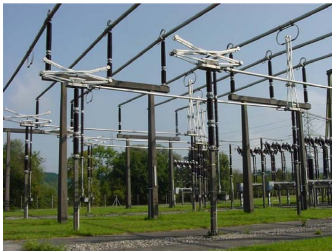
Bild 6.3 220 kV-Scherentrenner (Pantographen) in offenem (vorne) und geschlossenem (hinten) Zustand.
