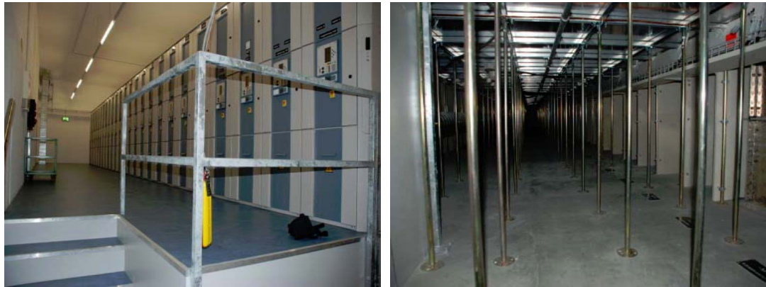
Bild 6.13: Eine Mittelspannungsanlage auf Gerüst, umgeben von einem Doppelboden (links) ohne Verstrebung gegen horizontale Kräfte (rechts: Blick unter den Doppelboden); im Erdbebenfall droht ein Einsturz.
