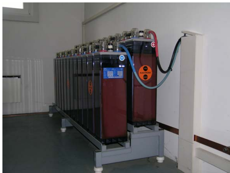
Bild 6.14: Hohe, schlanke Batterien für die ununterbrochene Stromversorgung des UW Chamoson: die ungesicherten Batterien stürzen schon bei einem relativ schwachen Beben ab, vgl. Bild 3.4.
