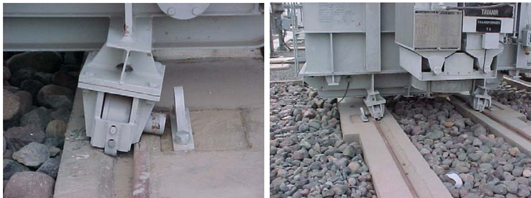
Bild 6.10: Versagen einer ungenügenden Verankerung eines 132 / 20 kV Transformators beim Erdbeben von Bam, Iran ( M_w = 6.5 ), 2003. (Foto: TREC, aus [2]).
