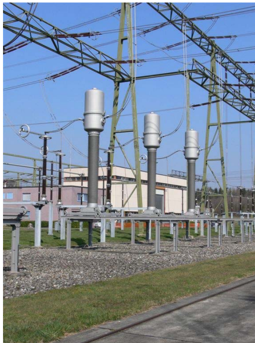
Bild 6.4 Messgruppe für 380 kV (Strom- und Spannungswandler kombiniert).
