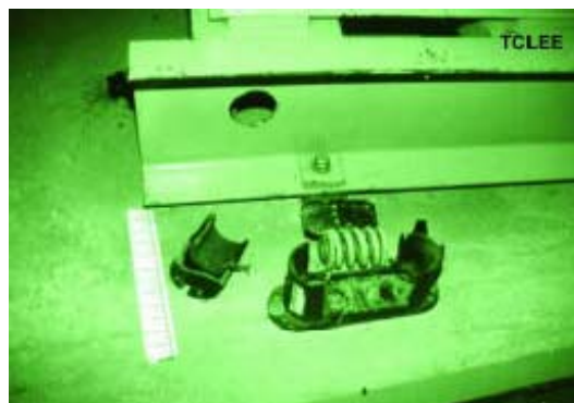
Bild 3.5: Das Versagen der Schwingungsdämpfung mit Gussgehäuse eines Notstromgenerators hat zum Bruch der Treibstoffleitung geführt; Chi-Chi-Beben ( M_w = 7.6 ), Taiwan, 1999 (Fotos: ASCE-TCLEE, aus [2]).
