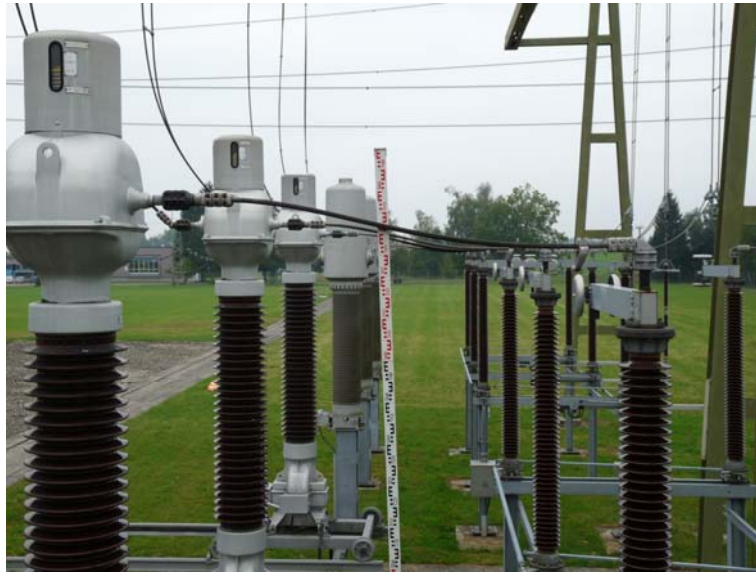
Bild 4.5: Nahaufnahme der in Bild 4.4 sichtbaren Leiterverbindungen zwischen Messgruppen und Schwenktrenner (220 kV) im UW Breite (Aufnahme aus der Gegenrichtung).
