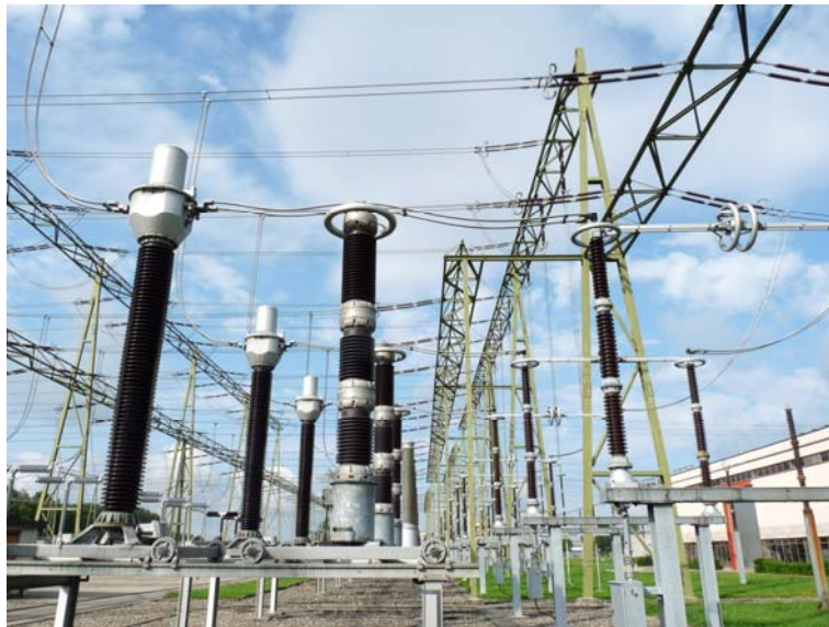
Bild 4.8: Leiterverbindungen zwischen Stromwandler, Spannungswandler und Schwenktrenner im Feld Trafo 32 (380 kV) des UW Breite.
