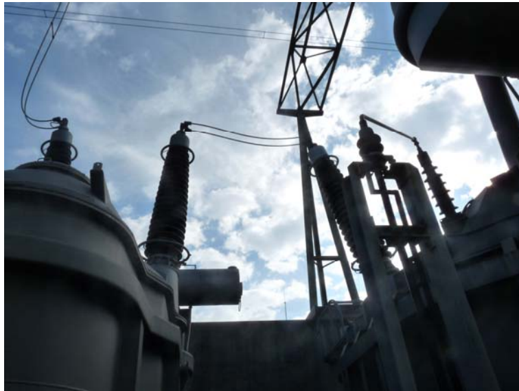
Bild 4.11: Leiterverbindung zwischen Haupt- und Regulierpol des Transformators 31 des UW Breite.
