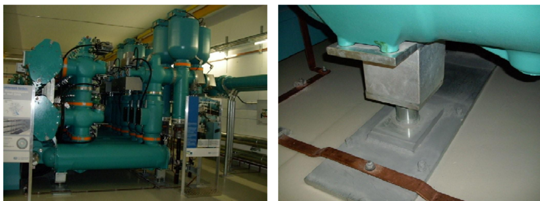
Bild 3.4: SF 6 -Anlage im UW Herdern (ewz): Verankerung in der Geschossdecke.
