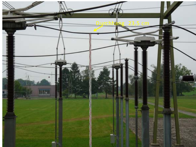
Bild 4.6: Leiterverbindung zwischen Pantographentrenner und Stützisolator im Feld Trafo 31 (220 kV) des UW Breite.
