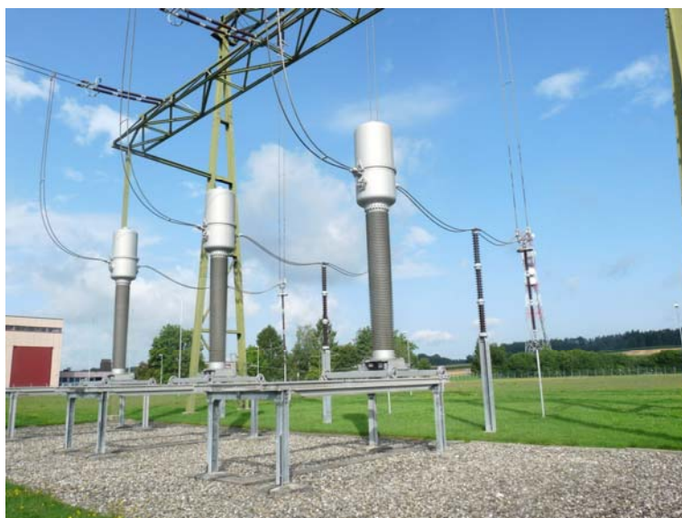
Bild 4.10: Leiterverbindungen zwischen einer Messgruppe Ritz KSKEF 450 und einem Stützisolator im Kupplungsfeld (380 kV) des UW Breite.
