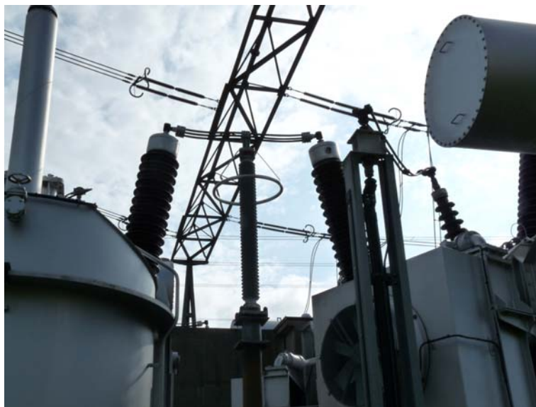
Bild 4.12: Leiterverbindung zwischen Haupt- und Regulierpol des Transformators 32 des UW Breite.
