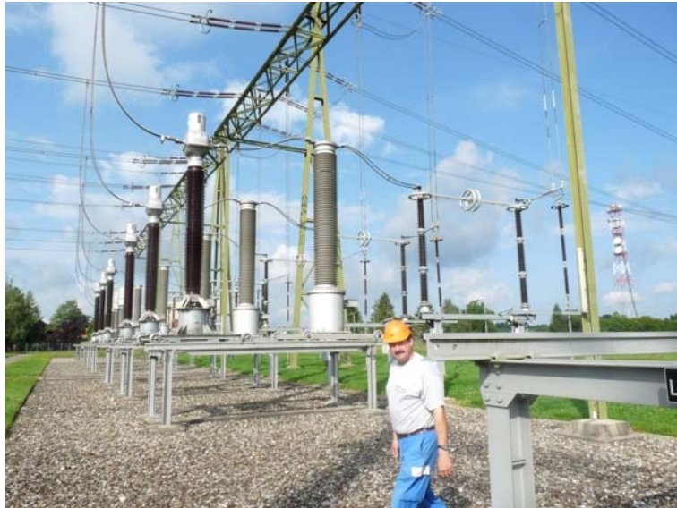
Bild 4.9: Leiterverbindungen zwischen Stromwandler, Spannungswandler und Schwenktrenner im Feld Lägern-Nord (380 kV) des UW Breite.
