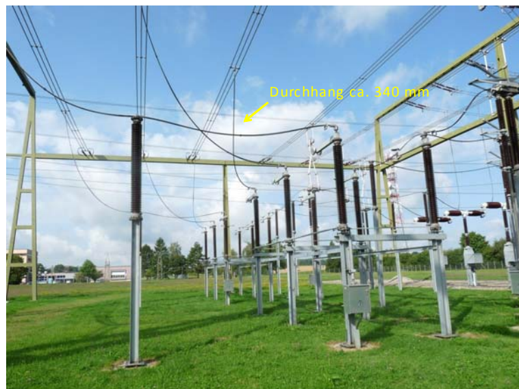
Bild 4.7: Leiterverbindung zwischen Stützisolator und Schwenktrenner im Feld Trafo 31 (220 kV) des UW Breite.
