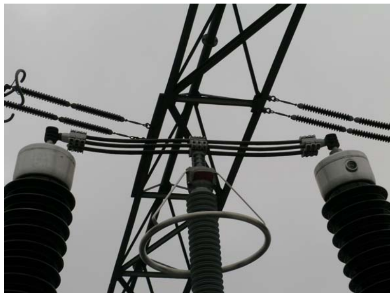
Bild 2.4: Leiterverbindung ohne ausreichende Lose zwischen einer Durchführung des Hauptpols und einer Durchführung des Regulierpols beim Transformator Sécheron 32 (380/220 kV) im UW Breite.
