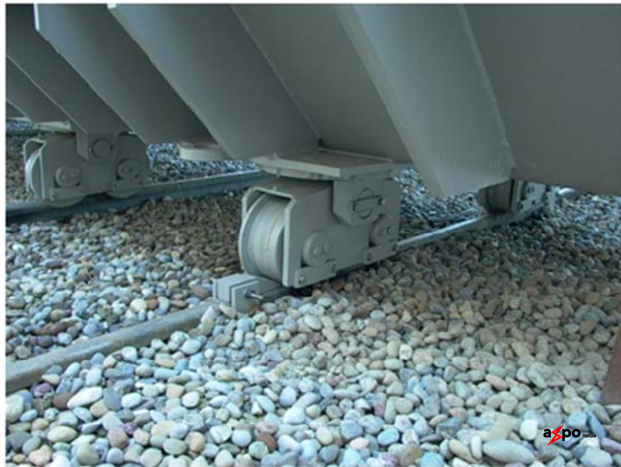
Abbildung 1 Doppelrollen mit Blockierung (am Schienenkopf festgeschraubt) 160-MVA-Transformator 220/110 kV, je nach Typ 180'000 bis 240'000 kg)
