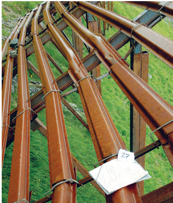
Abb. 117: Deformierte Rostbalken eines «Züllig SA»-Werkes in der Verbauung Ob der Mettenenalp, Unterschächen (UR) (Foto: R. Planzer, 08.08.2018).
