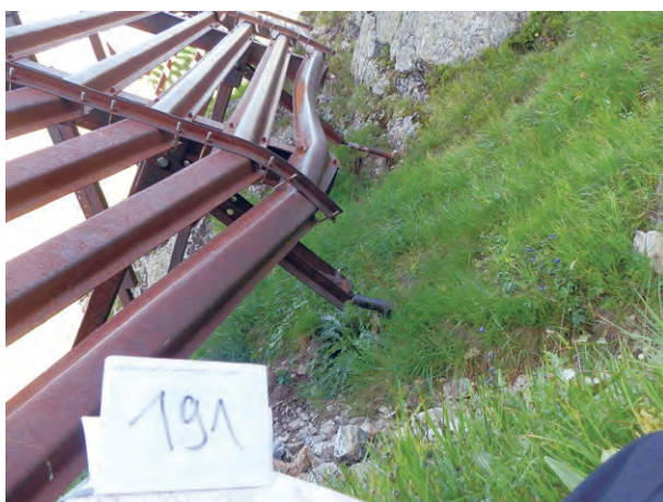
Abb. 118: Infolge Schneedrucks (u. a. wegen starken Schneegleitens) und zu grosser Distanz zwischen dem untersten Rostbalken und dem Boden wurde der bergseitige Zuganker von «Züllig SA»-Werken in der Verbauung Rinistock, Meien-Wassen (UR), deformiert (Foto: R. Planzer, 29.08.2018).
