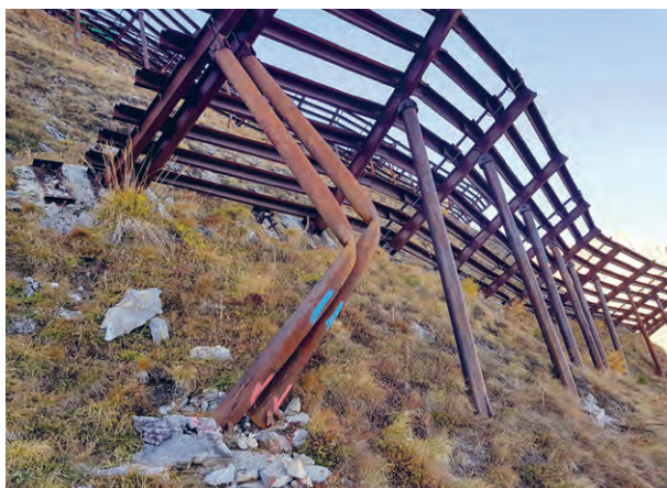
Abb. 112: Ausgeknickte Randstützen von Dickru-Stützwerken, Verbauung La Loutze, Leytron (VS). Im Randbereich herrschen erhöhte Schneedruckkräfte. Deshalb wurde ein Randwerk mit doppelten Trägern und Stützen eingebaut (Foto: Nivalp SA, 12.11.2018).
