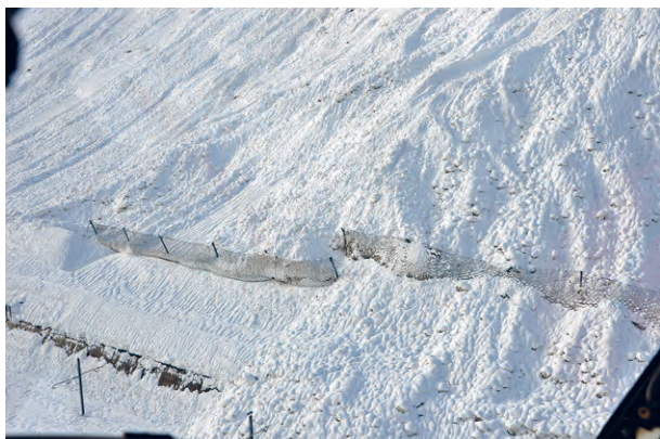
Abb. 136: Die Schafgrabenlawine eingangs Zermatt (VS) ging im Januar 2018 mehrmals nieder und beschädigte Steinschlagbarrieren, die zum Schutze der Bahnlinie der MGB errichtet worden waren. Die Steinschlagnetze sollen nun durch Dämme ersetzt werden (Foto: P. Stoebener, 10.01.2018).
