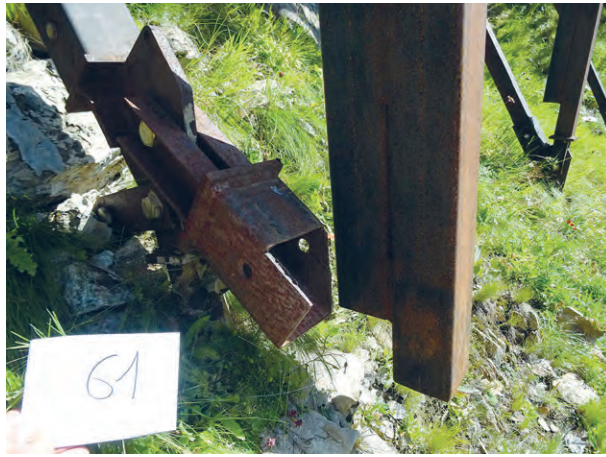
Abb. 115: Abgeknickter Stützenschuh bei einem «Züllig SA»-Werk mit verstärkter Doppelstütze, Verbauung Rinistock, Meien-Wassen (UR) (Foto: R. Planzer, 29.08.2018).
