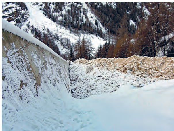
Abb. 131: Im Bielzug bei St. Niklaus (VS) wurde die 2016 erhöhte Ablenkmauer auf einem Schwemmkegel durch Lawinenablagerungen randvoll gefüllt. Die Höhe der Ablenkmauer variiert zwischen 5 und 10 m. Ein weiterer Niedergang hätte einen Gittermasten einer Hochspannungsleitung und Wohnhäuser gefährden können. In der Folge wurden die Lawinenablagerungen maschinell entfernt (Foto: Geoformer, 05.01.2018).
