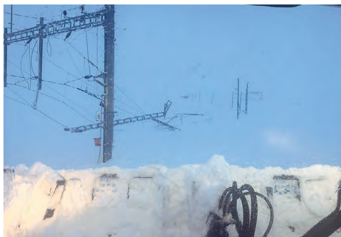
Abb. 73: Die beschädigte Oberleitung am 22. Januar 2018 abends. Blick von der Station Oberalppass in Richtung der Galerie auf der Urner Seite (Foto: Andermatt-Sedrun Sport AG, 22.01.2018).
