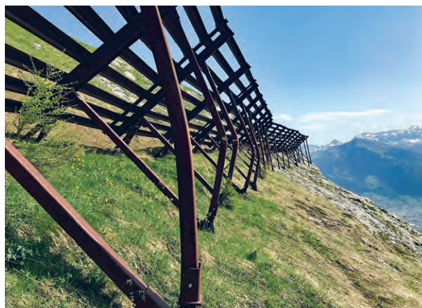
Abb. 113: Ausgeknickte Stützen von Züllig-SA-Stützwerken, Verbauung Stelli, Untervaz (GR). In dieser Verbauung gab es bereits in den Wintern 1994/95 und 1998/99 Stützenschäden (Foto: M. Kalberer, 30.05.2018).
