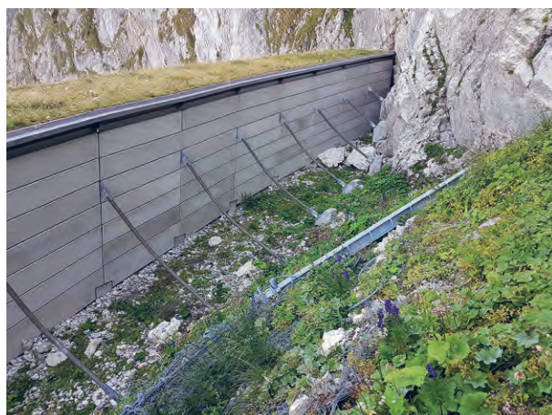
Abb. 135: Die bergseitigen Rückhaltestreben der Galerie Naye Aval wurden durch Schneedruckeinwirkungen verbogen resp. brachen. Weiter wurden einige Stahlträger deformiert (Foto: Geobrug, 22.08.2018).
