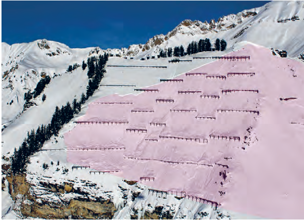
Abb. 110: Stützverbauung Urseren, Brienz (BE), in der Lawinenperiode vom 21./22. Januar 2018 brach in der Verbauung grossflächig eine Schneebrettlawine an. Die Anrissshöhe dürfte rund 50 cm betragen haben. Die Lawine verursachte keine Schäden (Foto: U. Ryter, 24.01.2018).
