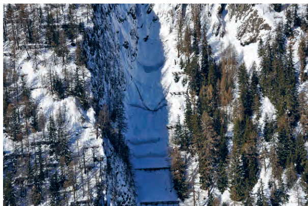
Abb. 137: Im Lawinenzug Wandschluichen im Lötschental (VS) wurden Stahlschneebrücken und Steinschlagbarrieren eingebaut. Im Januar 2018 wurden einige Steinschlagbarrieren durch Lawinen und Schneedruckeinwirkungen beschädigt. Ähnliche Schäden waren bereits in früheren Wintern aufgetreten (Foto: SLF/S. Margreth, 24.01.2018).
