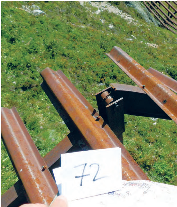
Abb. 116: Infolge Überschneiens gebrochener IPE-Träger bei einem «BEDO»-Werk in der Verbauung Rinistock, Meien-Wassen (UR). Ist ein Werk überschneit, entsteht im Träger das grösste Biegemoment im Bereich des Stützenaufagers (Foto: R. Planzer, 29.08.2018).
