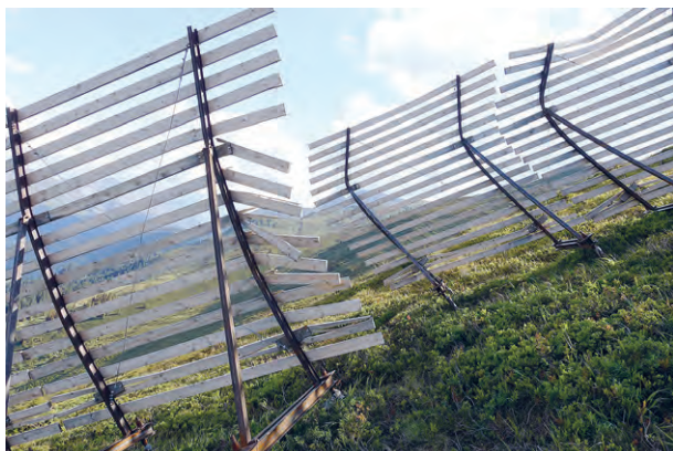
Abb. 124: Beschädigter Triebsschneezaun Valtschamela, Churwalden (GR). Der Triebsschneezaun besteht aus 4 m breiten Einzelementen, die mit vier Mikropfählen verankert sind. Durch den seitlichen Schneedruck wurde der Zaun in Talrichtung deformiert (Foto: SLF/S. Margreth, 17.08.2018).
