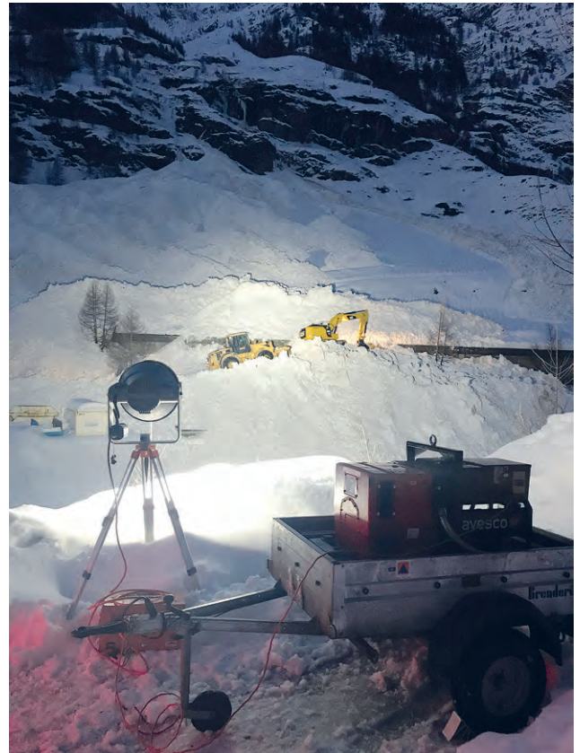
Abb. 140: Mächtige Lawinenablagerungen auf der Strasse Täsch–Zermatt (VS) im Lawinenzug Luegelbach. Räumung mit Bagger und Pneulader, auch nachts (Foto: P. Steffen, 10.01.2018).
