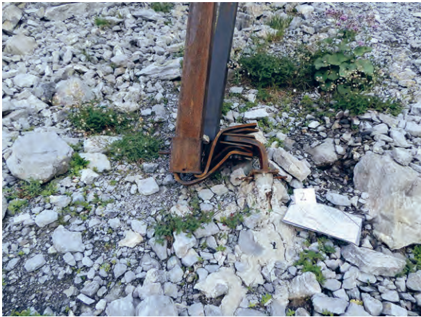
Abb. 114: Verbogene Stützen-Anschlusslaschen bei «Voest-Alpine BT»-Werken, Verbauung Grotzenegg, Unterschächen (UR) (Foto: R. Planzer, 22.08.2018).
