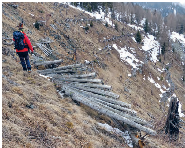
Abb. 121: Die «Val da Barcli»-Lawine vom 23. Januar 2018 zerstörte rund 460 m Holzschneerechen des Typs «SLF» mit Schwellenschuh. Die Verbindung der Stütze mit der Fussplatte stellte sich beim Lawinenaufprall als Schwachpunkt heraus. Da die Stütze nicht kraftschlüssig mit der Fussplatte verbunden ist, genügten relativ kleine Kräfte, um die Stütze wegzudrücken. Bei praktisch allen zerstörten Werken wurden die Stütze und die Pfette weggerissen (Foto: SLF/S. Margreth, 27.03.2018).
