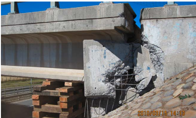
Schaden an einem Brückenwiderlager (Chile, 2010) 5
