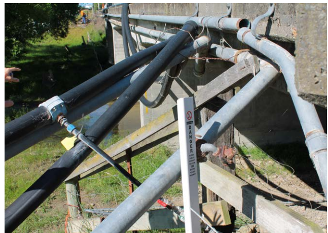
Provisorische Reparatur eines Wasserleitungsbruchs, Ursache differentielle Setzung einer Brücke (Kaikoura, 2016) 10
