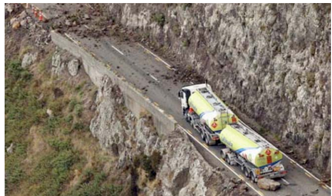
Steinschlag auf Strasse (Christchurch, 2011) 6
