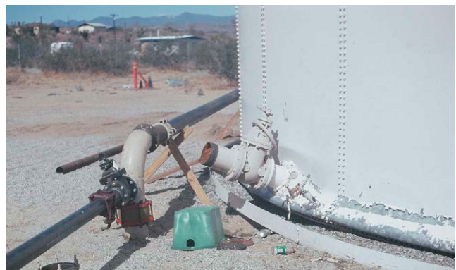
Zuleitungsbruch aufgrund Tankhebung ausgelöst durch Flüssigkeitsbewegungen im Tank (Bsp. Wassertank) 4
