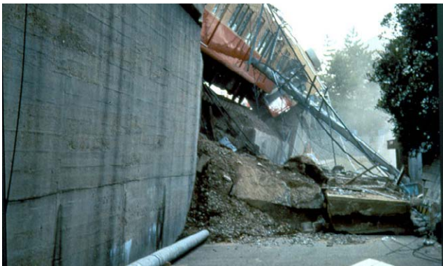
Eingestürzte Stützmauer (Kobe, 1995) 7
