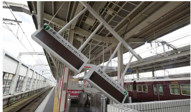
Schäden an Bahnhofsanlagen (Takatsuki, 2018) 8
